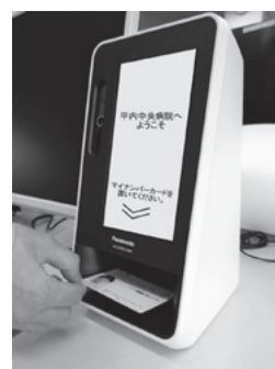
▲設置された顔認証付きカードリーダー
