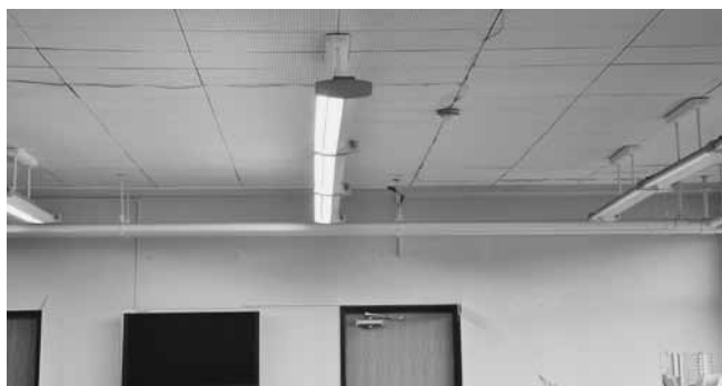
蛍光灯は半分のみ点灯
