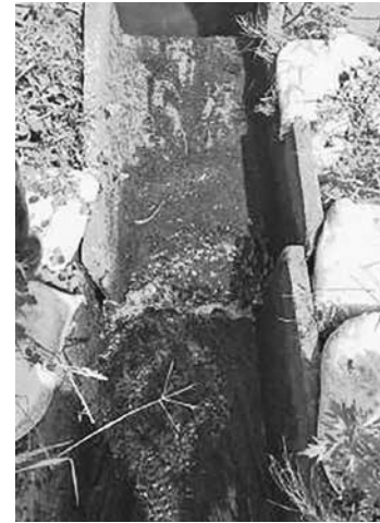
破損した水路の整備を
