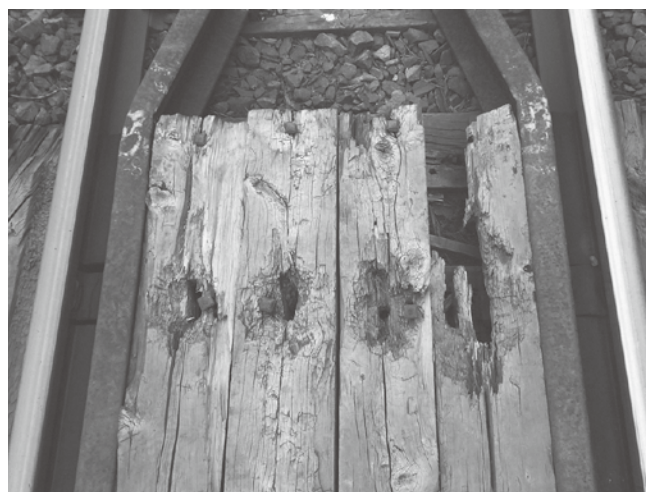
老朽で傷んでいる木製踏切板（石上踏切）
