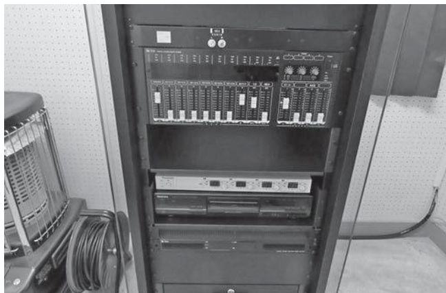
小湊小 放送設備
