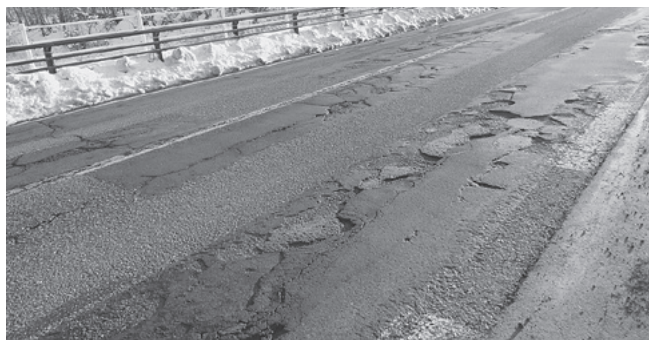
テンプラ舗装では済まない損傷
